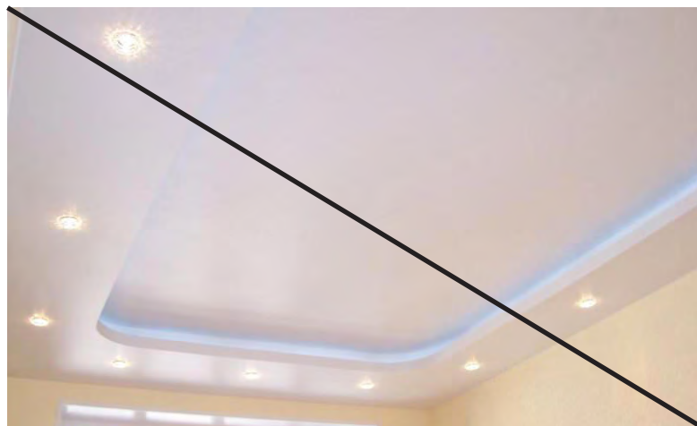
Плохо Многоуровневые гипсокартонные конструкции
